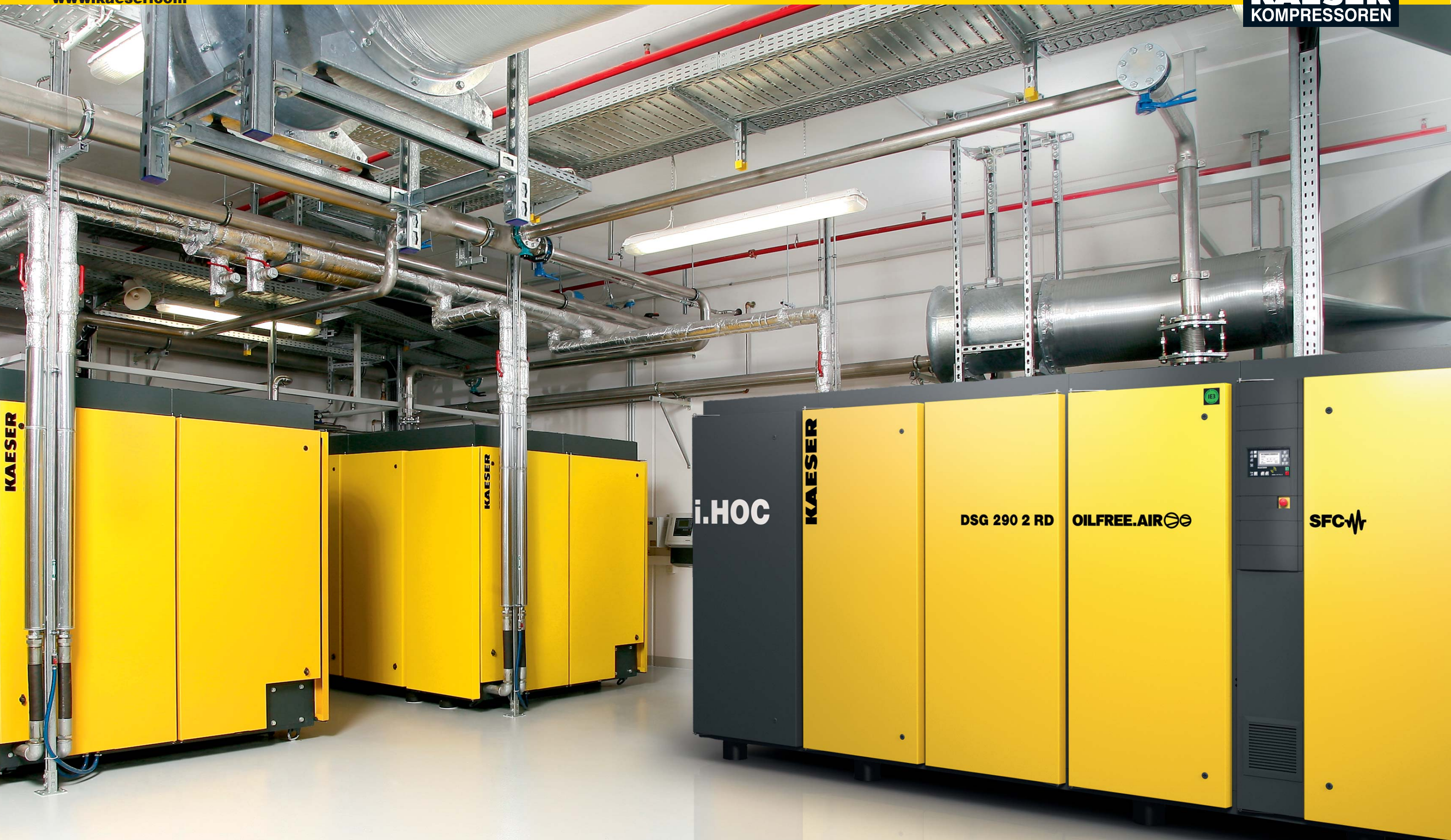
Abb.: Beispielhafte Darstellung einer KAESER-Station, die um einen trocken verdichtenden Schraubenkompressor von Typ DSG 290-2 RD SFC wassergekühlt erweitert wurde.
